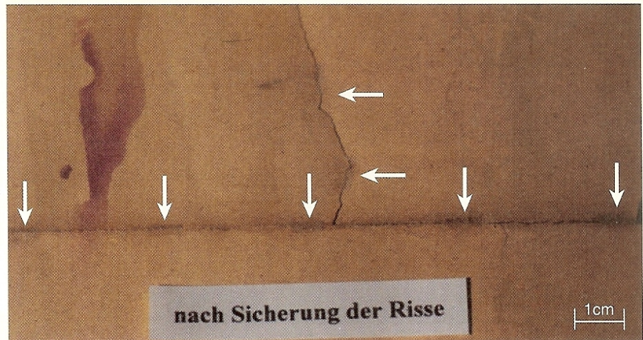
Abb. 13: Mit Sicherungsbrücken gesicherte Risse (Pfeile)
